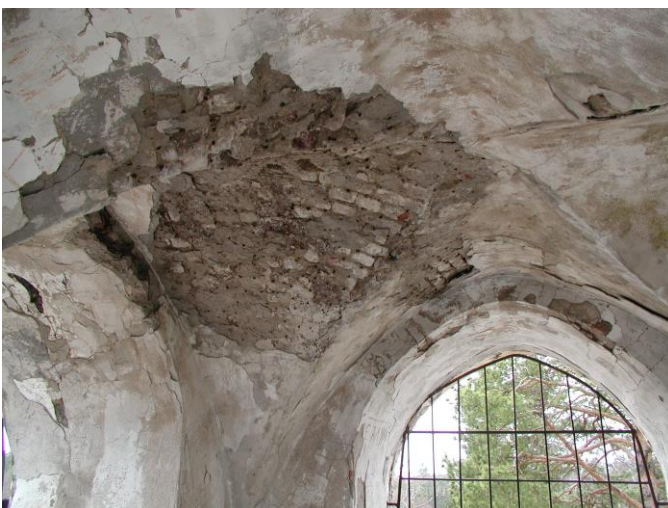
Bild 118. Rappningen har lossat även på valvets insida. (TAMK)
