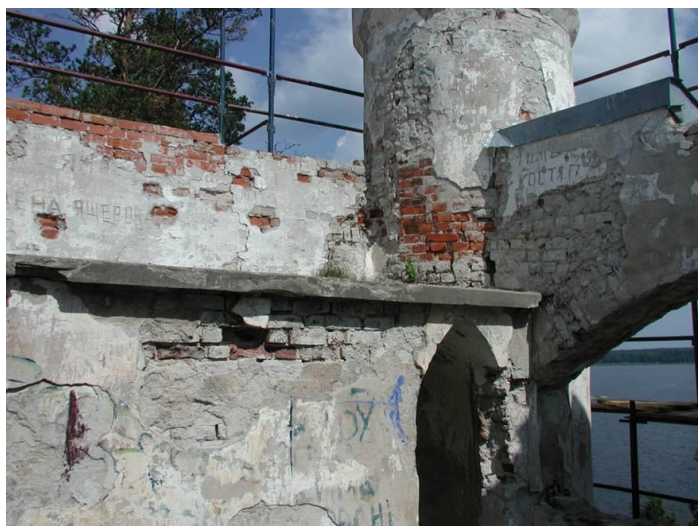
Bild 115. Rappningen har lossat och teglets ytlager har delvis brutits loss. (TAMK)
