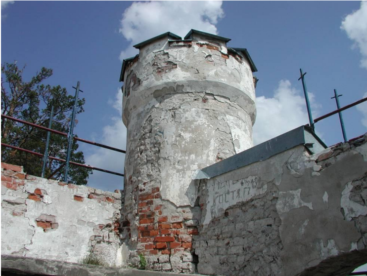
Bild 116. Gravslottets torn har blivit hårt utsatta. Plåtarbetena ger ett intryck av att vara provisoriska. (TAMK)
