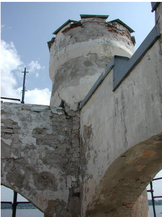
Bild 117. De välvda balkarna mellan tornen har spruckit. (TAMK)
